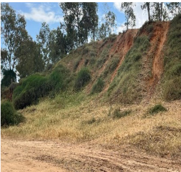
"קוליסים" שנוצרו מנהיגת רכבי שטח בגבעות צמחייה נמוכה סמוך לרוחמה. צילום: מאיה מלאת
